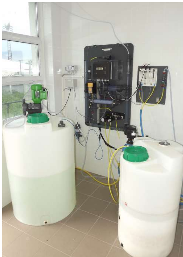
A berendezés üzem közben
