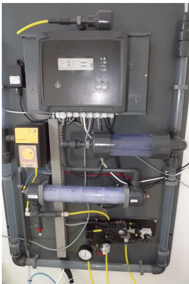
A hypó gyártó berendezés üzeme
