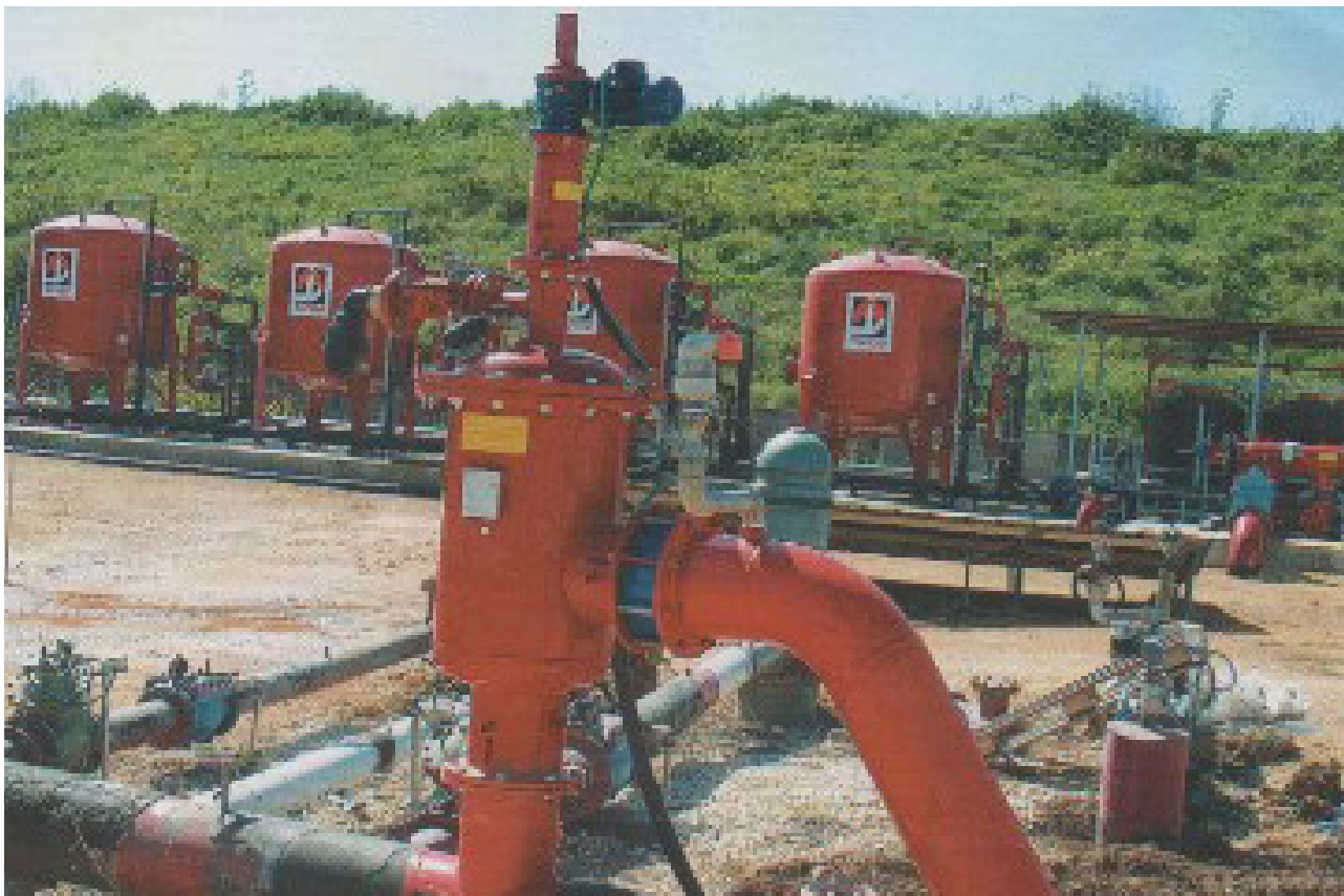
1. ábra Szennyvíztisztító-telepő szűrő berendezése a korlátlan öntözéshez [Golovaty, 2008]
