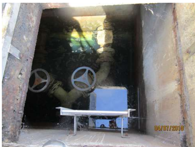
3. kép: Rozsdamentes szerkezeti elemek szénacél kötőelemekkel rögzítve
