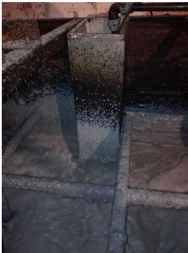
5. ábra –Szivattyúvédő szűrőház a Puffer 1 tartályban
