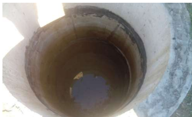
1. kép: Illesztési hézagok hibájának utólagos vízszigetelése vegyszertároló tartály kármentő medencéjében
