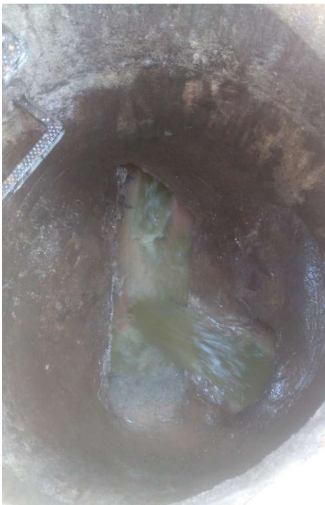
4. kép: Betonkorrózió új építésű tisztítóakna künetében
