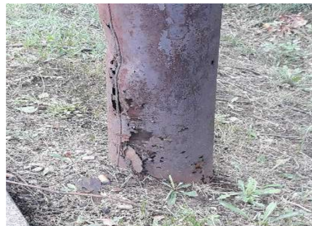
Jelentős mértékben korrodált, védelem nélküli kútfej-szellőzőcső kivezetés a talajon keresztül (a szerző saját felvétele, 2019.)
