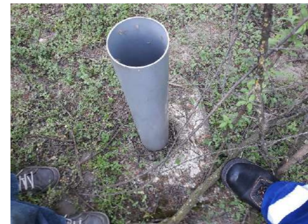
Lezáratlan monitoring kút (a PVC-rakat védelmét biztosító acélcsövet és a zárósapkát eltulajdonították) (a szerző saját felvétele, 2019.)
