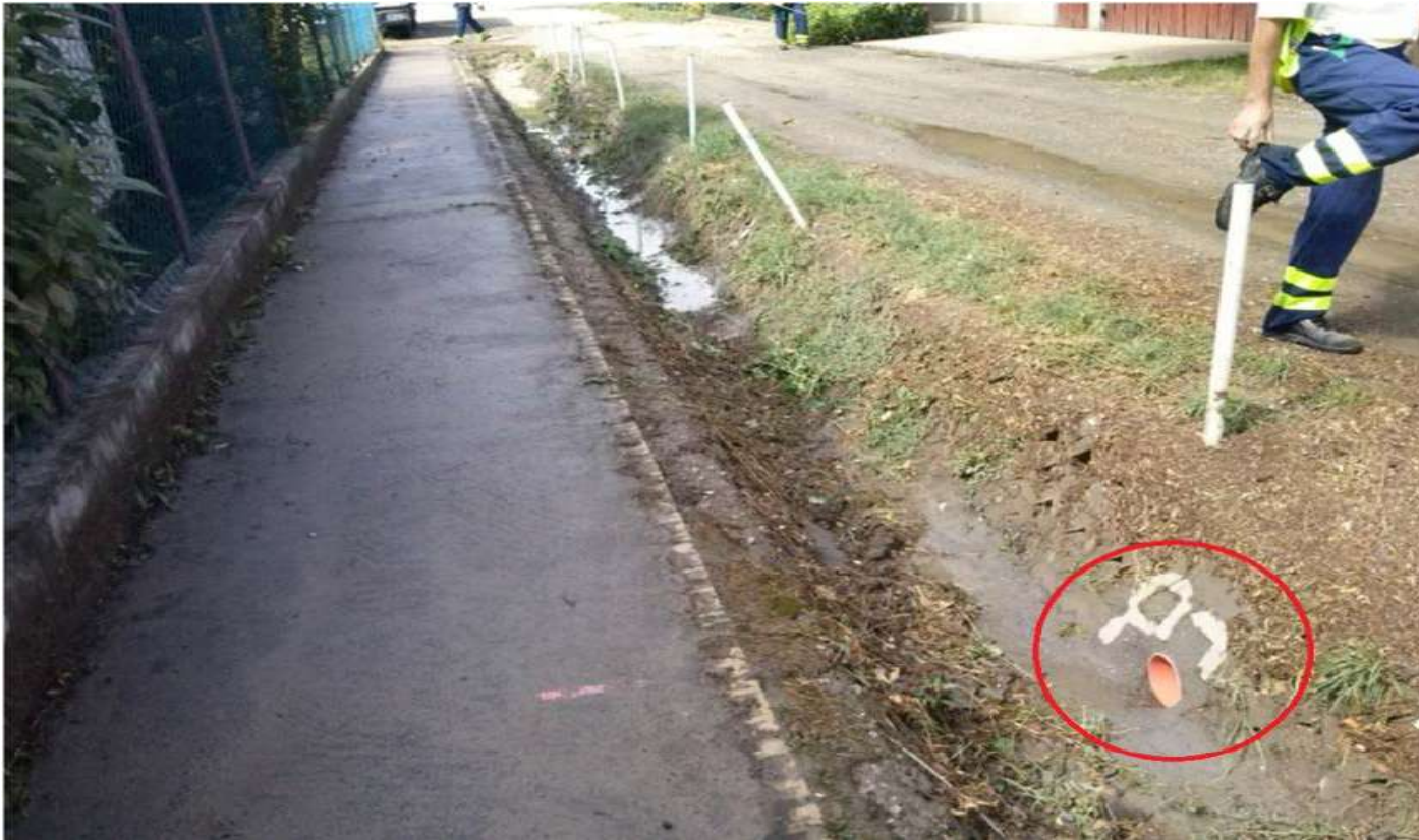
Szikkasztó árok illegális bekötése a szennyvízcsatornába
